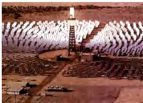
图 18-12 太阳能发电装置
