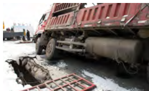
图 8-15 超载损坏桥面
