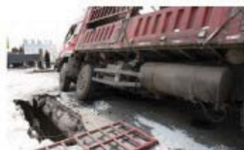
图 8-15 超载损坏桥面
