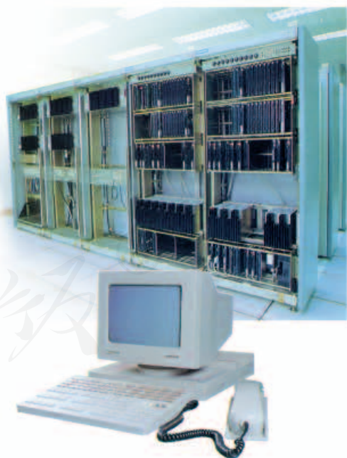
图 21.1-6 程控电话交换机和操作台
