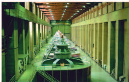
图20.5-6 现代水力发电厂中的发电机组。发电机的轴是竖直安装的，轴的下面连接着水轮机，在强大水流的冲击下旋转。
