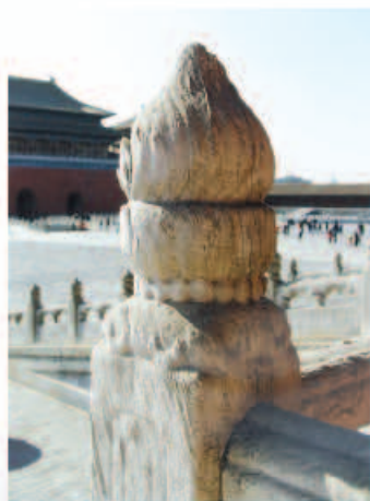
图22.4-3 被酸雨严重腐蚀的汉白玉石柱
