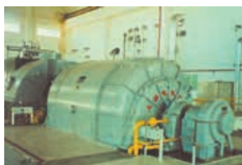
图 8-1-9 大型发电厂的发电机组
