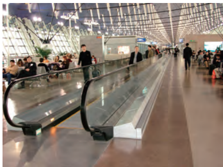
图7-4 机场候机楼中的自动人行道
