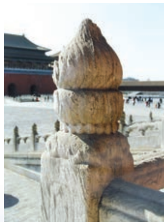
图22.4-3 被酸雨严重腐蚀的汉白玉石柱
