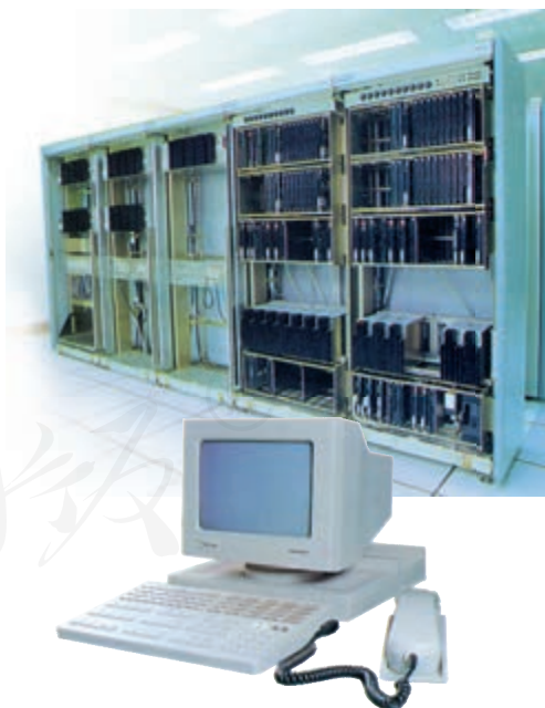
图21.1-6 程控电话交换机和操作台
